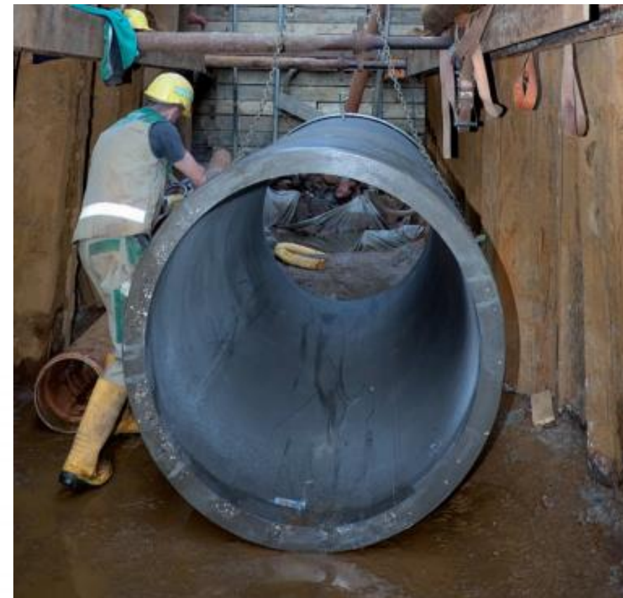
19. attēls: Notekūdeņu caurule. Avots: hamburgwasser.de
